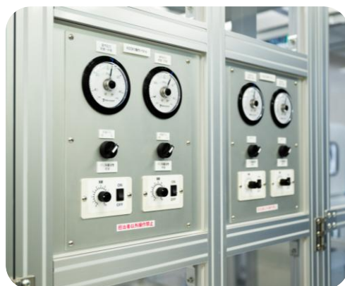
クリーンルーム内の差圧調整
